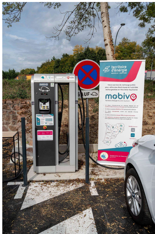
Figure 38 - Bornes de recharges électriques aire de covoiturage Malemort - correze.fr
